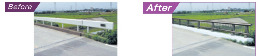
m. 防護柵、高欄本体に錆がかなり進行している場合
