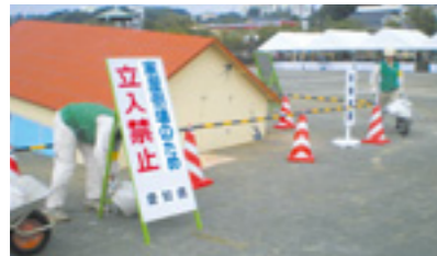
倒壊家屋への立入禁止措置
