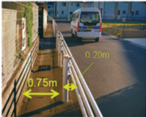
写真-1 生活道路に車両用防護柵を設置した例
