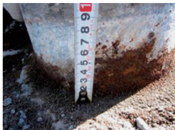
支柱地際部の腐食状況
