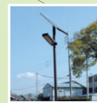
P.4 LED照明灯
