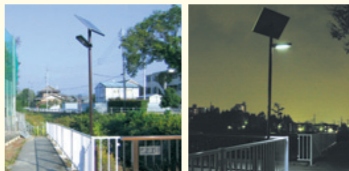
通学路に防犯灯としてLED照明灯を設置。災害時には誘導灯としても機能します。 LED照明灯(夜間の様子)
