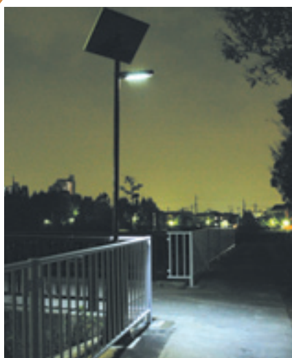
LED照明灯（夜間の様子）
